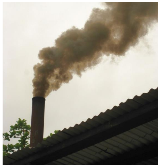
Figure 3. Dégagement de fumées suite à une combustion incomplète des coques d'anacarde en chaudière 8
