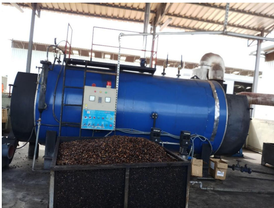
Figure 3 : Chaudière installé à ICN
